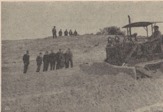
Assistindo aos trabalhos para a construção de uma estrada florestal (S.ra da Vitória - Marinha Grande)
